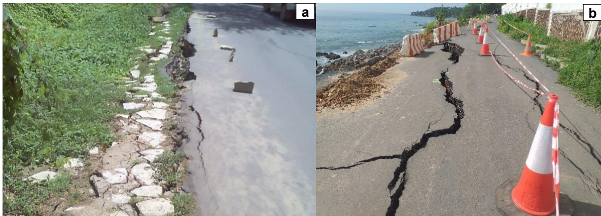
Figure 1 Érosion côtière et protection sur la corniche Est de Dakar (a : instabilité d'une pente support de chaussée routière, b : évidence de l'instabilité et déviation du trafic après démarrage des travaux de protection côtière)
